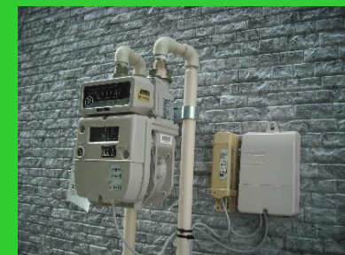
④メーター検針 保守点検
