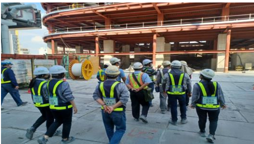
↑ 3月/14日勞檢人員至現場開立有無缺失
