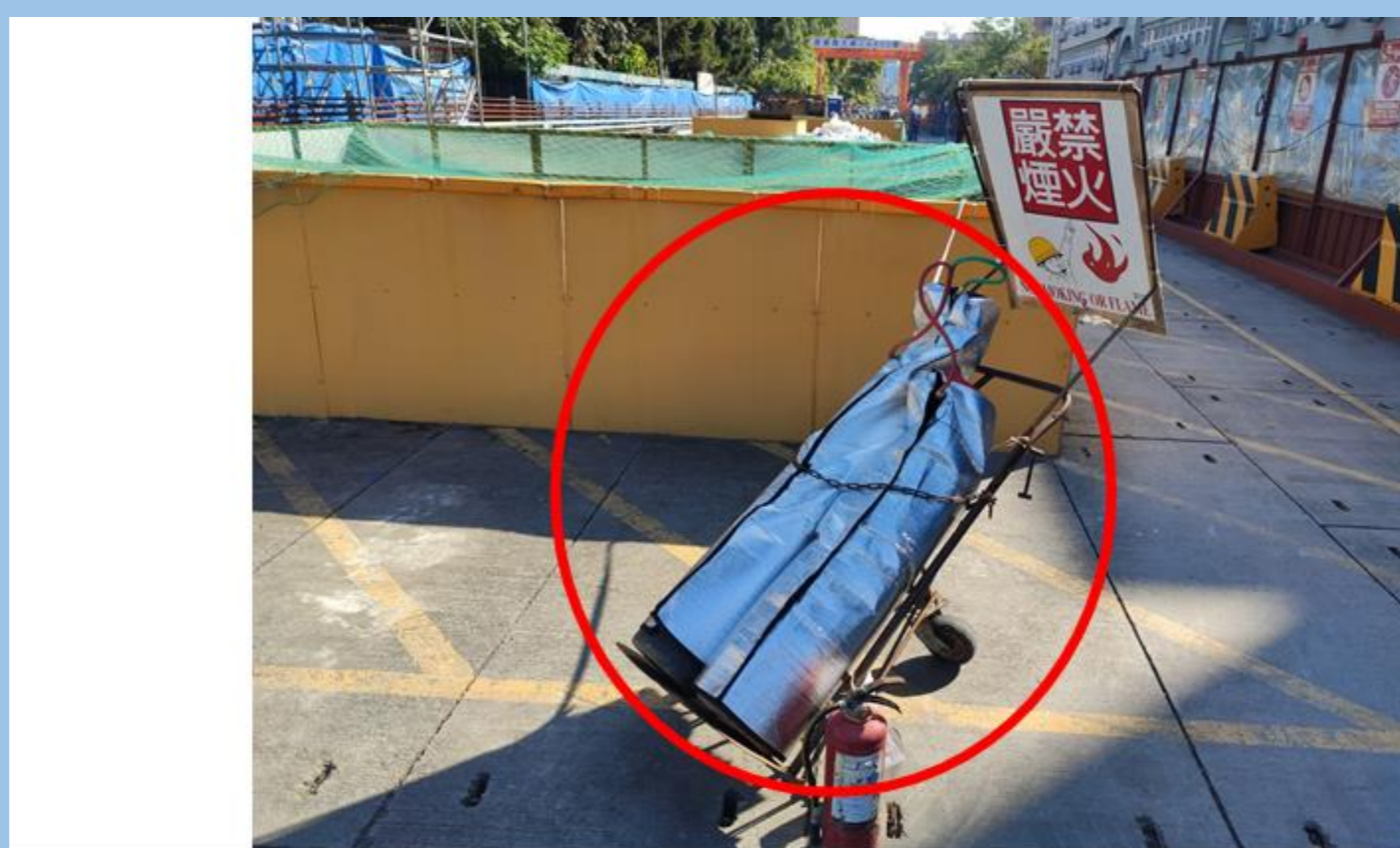
項次：1。照片說明：為防止高壓鋼瓶表面溫度過高，請於氧氣乙炔鋼瓶外部使用隔熱墊，防止室外陽光直射鋼瓶外部造成鋼瓶表面溫度大於40度。
