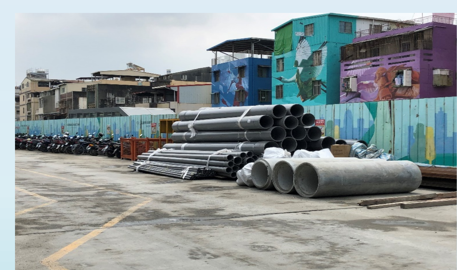
圖4:施工區巡視缺失
