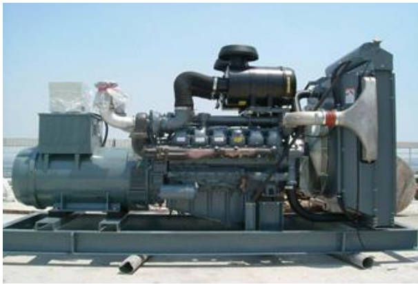
圖一 柴油發電機[2]。
