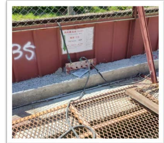
每工區旁都會有接地匯流排 (感電危害)
