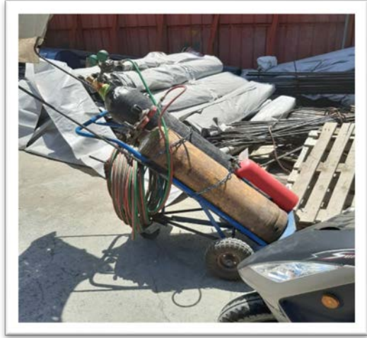
乙炔氧氣鋼瓶旁設置滅火器(火災爆炸危害)
