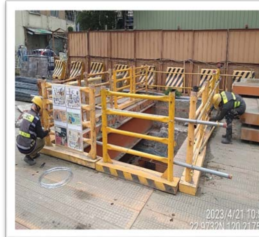
安全欄杆檢點 (墜落危害)
