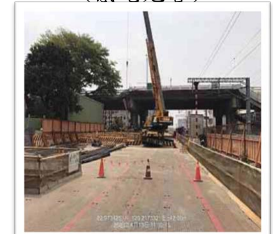
火車經過，吊掛作業停止 (物體飛落危害)
